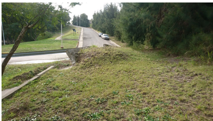
Figura 32. Acumulación de suelo y vuelco de muro de contención, debido al reptaje lento, pero continuo del suelo.
