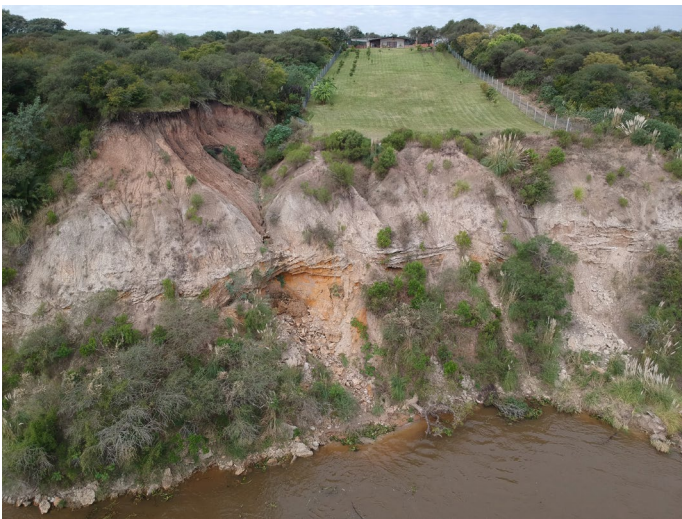
Figura 19. Erosión fluvial por carcavamiento de las unidades geotécnicas I y II, con base en las calizas de la Unidad Geotécnica III. La erosión continúa sobre la Unidad Geotécnica IV, provocando el descalce y posterior caída de las calizas y arenas cementadas.
