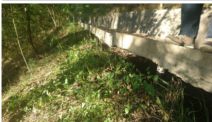
Figura 36. El movimiento de reptaje del suelo ha descalzado la estructura rígida de sostenimiento, quedando apoyada en los pilotes. En algunos sectores, se observan asentamientos y basculamientos de la estructura.
