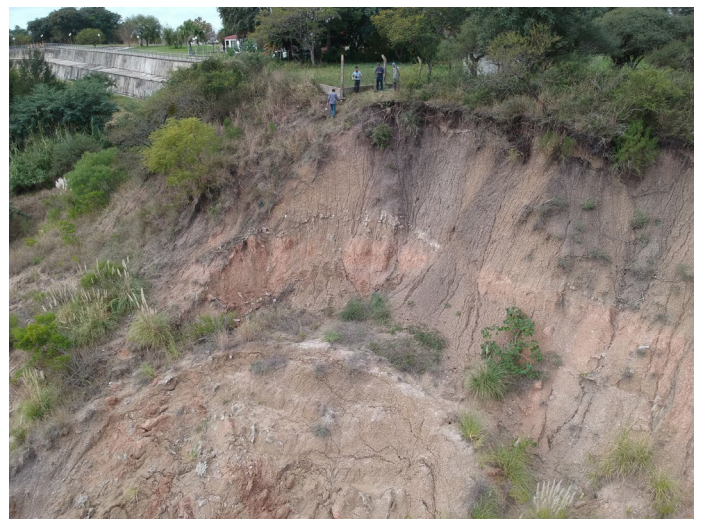
Figura 23. Deslizamiento rotacional profundo, que abarca las unidades geotécnicas I y II. En el sector superior izquierdo de la foto se puede apreciar la obra de sostenimiento, diseñada para evitar este tipo de procesos.
