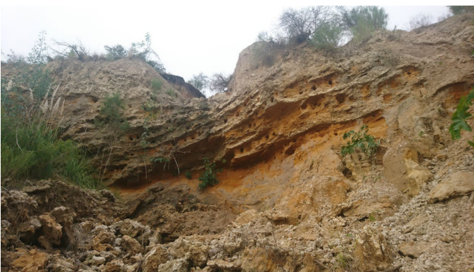
Figura 20. Detalle del sector representado en la figura 19, donde se aprecian los tabiques calcáreos en voladizo, producto de la erosión de la matriz arenosa, correspondientes al sector superior de la Formación Ituzaingó (Unidad Geotécnica III). Los fragmentos calcáreos caídos al pie dan cuenta de la situación de equilibrio límite.
