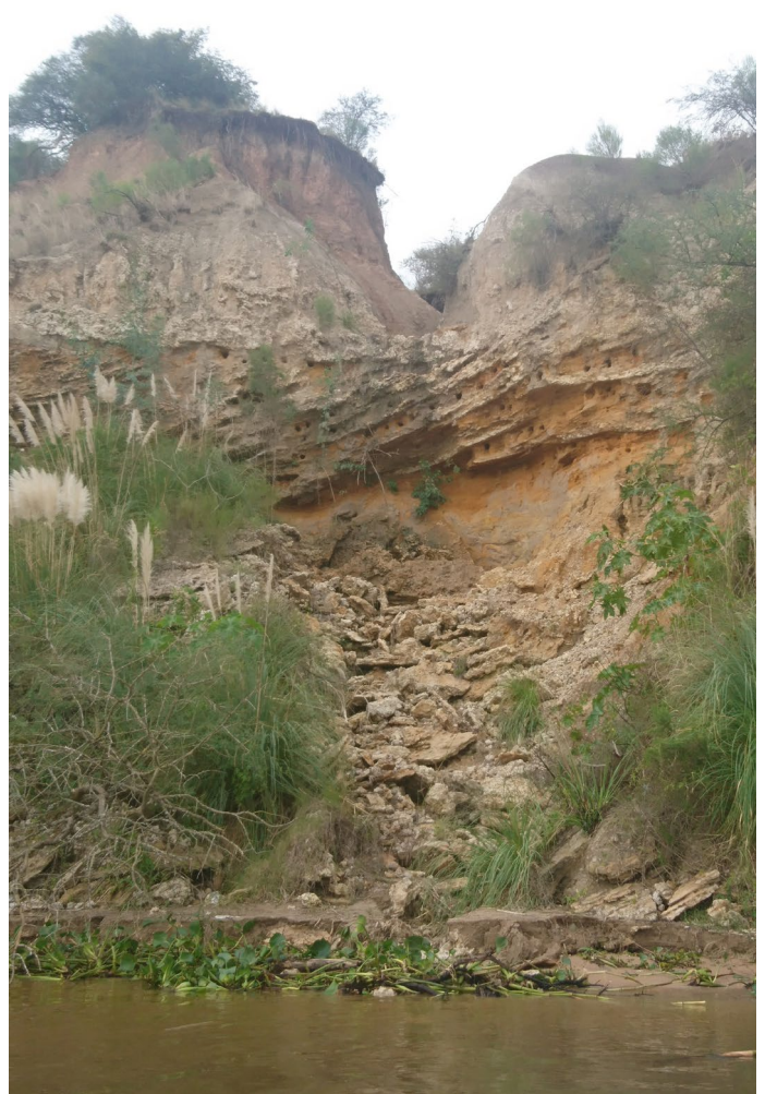
Figura 39. Depósito de caída de rocas carbonáticas y areniscas cementadas de la Unidad Geotécnica III, por erosión de las arenas no cementadas de la Unidad Geotécnica IV. La erosión se debe al agua que escurre superficialmente desde el coronamiento de la barranca, generando el carcamamiento de las arcillas de la Formación Hernandarias. La Unidad Geotécnica III funciona en este caso como un nivel de base local, generando una cascada durante los períodos de lluvias, permitiendo la erosión de las arenas inferiores, y su consecuente descalce y colapso.
