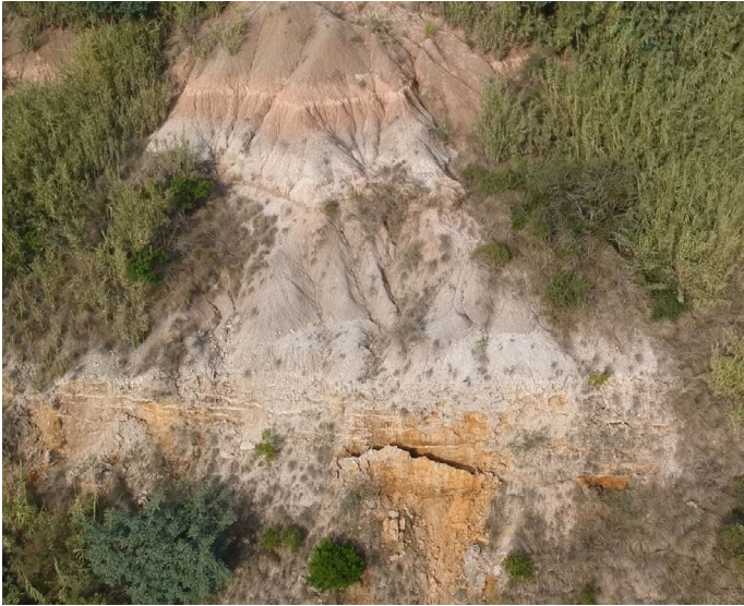
Figura 40. Vista aérea de banco de areniscas cementadas de la Formación Ituzaingó (Unidad Geotécnica III), atravesadas por estalactitas que inclinan a contrapendiente, con un alto ángulo respecto a la horizontal, en una situación de equilibrio límite.
