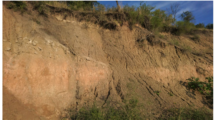
Figura 21. Cono de deyección generado por caída de suelos desde el borde de la barranca.
