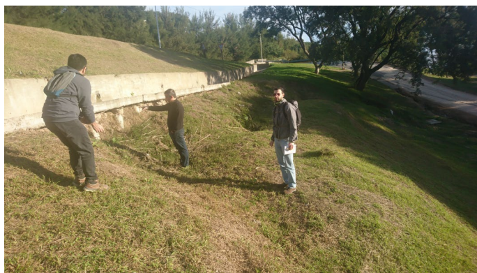
Figura 35. El movimiento de reptaje del suelo ha dejado a la vista los pilotes inicialmente enterrados, que forman parte del sistema de sostenimiento de la ladera, en la zona del puerto.
