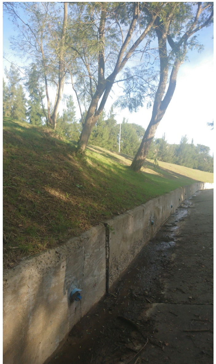
Figura 31. Árboles inclinados debido a un proceso de reptaje del suelo superficial en las cercanías de la cuneta colectora de cota 38.
