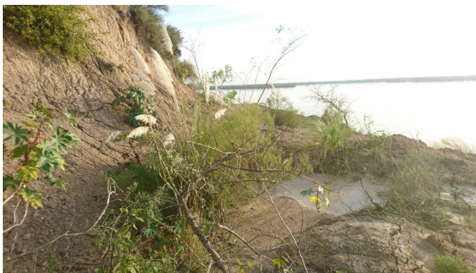
Figura 25. Estancamiento de agua en la terrazuela de un deslizamiento rotacional, generado por el basculamiento que impide el adecuado drenaje superficial. Esta acumulación de agua puede generar posteriores flujos de tierra dentro del material fino deslizado.
