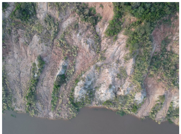
Figura 27. Vista en planta de depósitos de flujos de tierra, al sur de la localidad de Villa Hernandarias.
