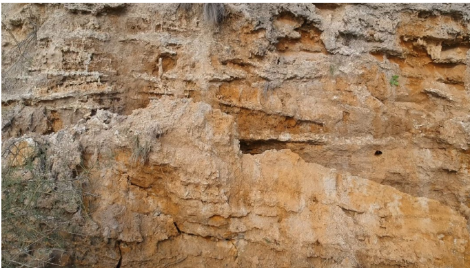
Figura 41. Detalle de la figura 40, donde se aprecian las areniscas ocreas de la Formación Ituzaingó, atravesadas por tabiques calcáreos y estalactitas, que estructuran su estratificación, permitiendo el vuelco y posterior caída de rocas.
