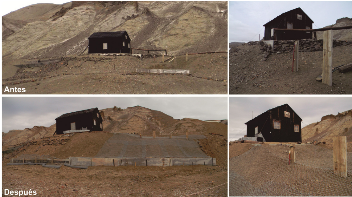
Figura 9: Detalle de la zona con subsidencia debido a procesos de termokarst al sudoeste de la cabaña, antes y después de los trabajos de mitigación.
