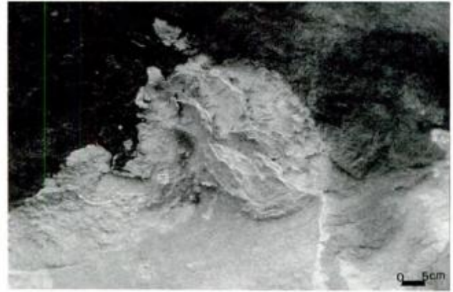
Figura 4: Láminas de roca de 2 - 3 mm de espesor que se desprenden en el techo de los tafonis .
